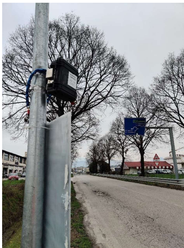
Figura 12: Dispositivo radar installato su via Caduti sul Lavoro
