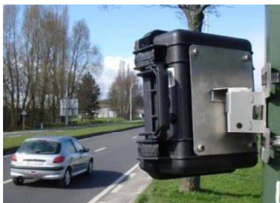
Figura 6: Esempio strumentazione radar Icoms TMS-SA4
